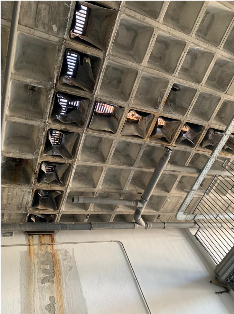
Canal drenante por la parte inferior que da al parking.
