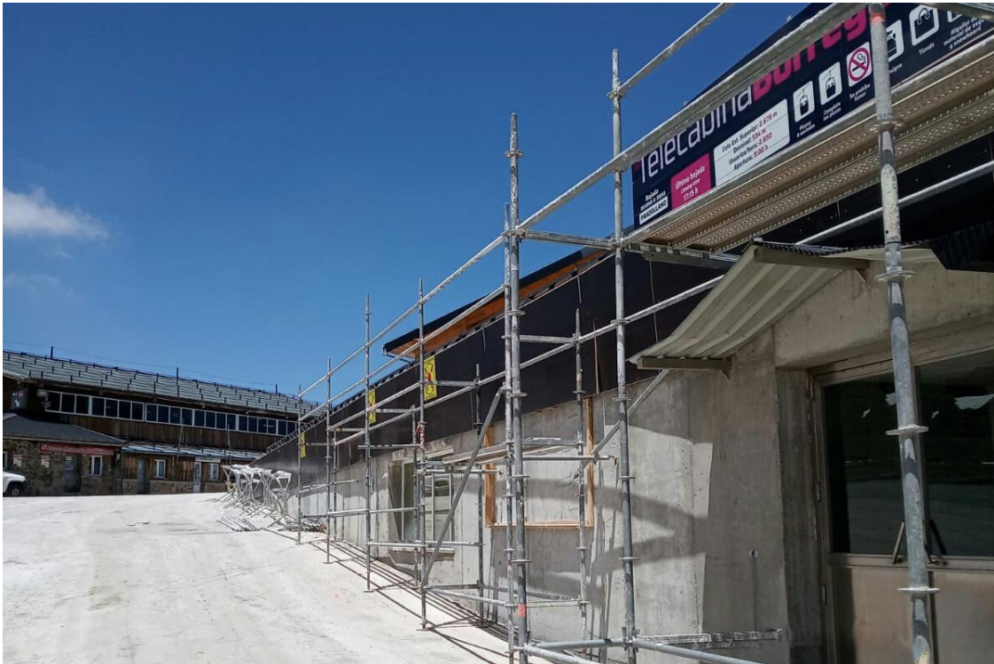
Imagen 6. Lateral de la Terraza Borreguiles, en su perímetro se construirá el zuncho y se volverá a panelar.
