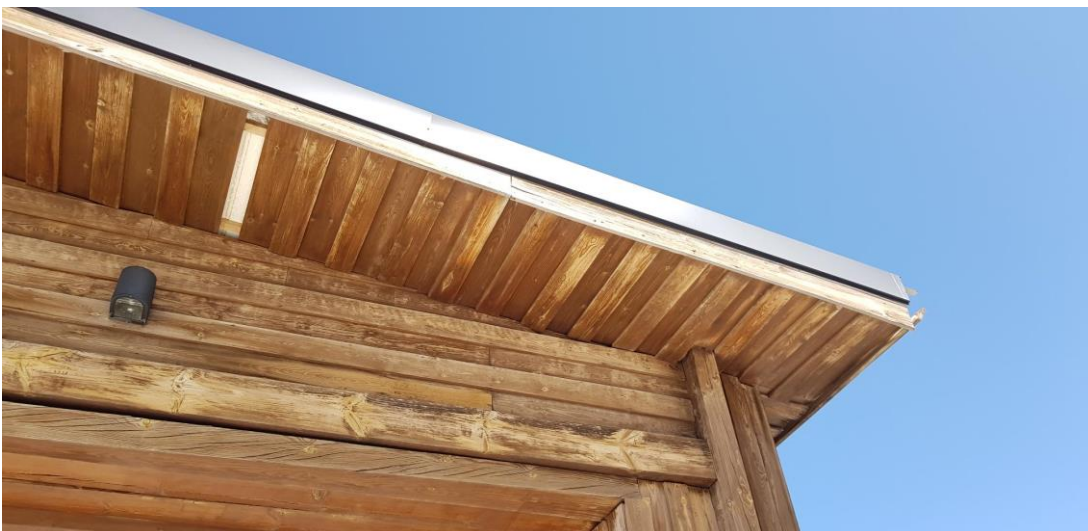
Imagen 8. Lateral Aleros para reparar y reponer las maderas que falten.
