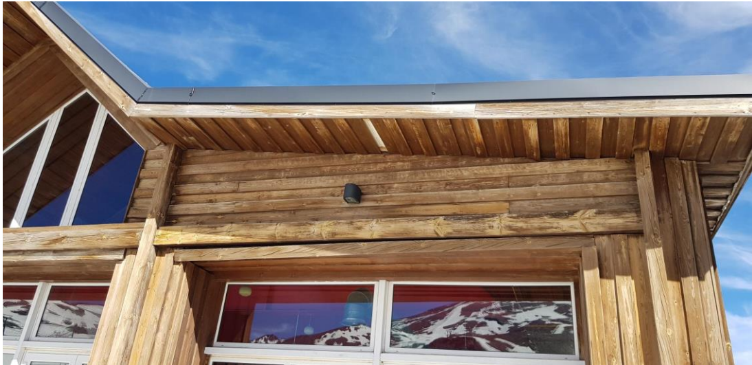
Imagen 4. Fachada sureste a panelar, aleros, pilastras y dinteles de fachada para reparar.
