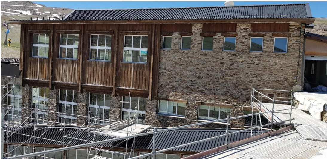
Imagen 5. Fachada Noreste a panelar, pilastras, aleros y dinteles a reparar.
